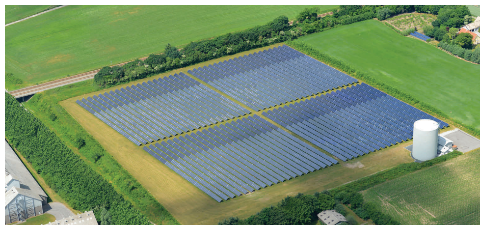
Vrå Varmeværk investerede i 2015 30 mio. kr. i dette solvarmeanlæg, som sammen med varme fra GrønGas Vrå leverer grønt varme til forbrugerne i byen.
